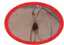
Câble de la bande lumineuse LED
